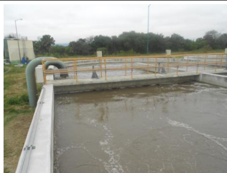
Ciudad Victoria WWTP
