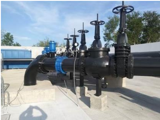
Estación de Bombeo No. 1
