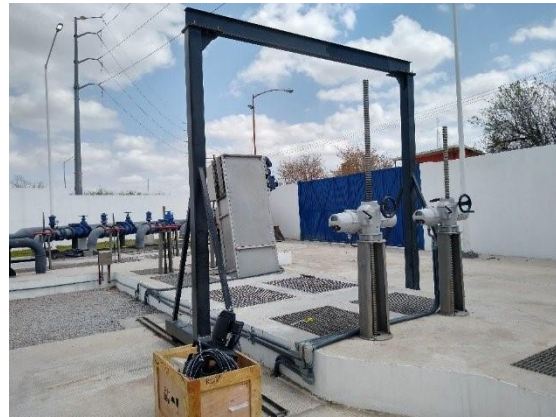
Estación de Bombeo No. 278
