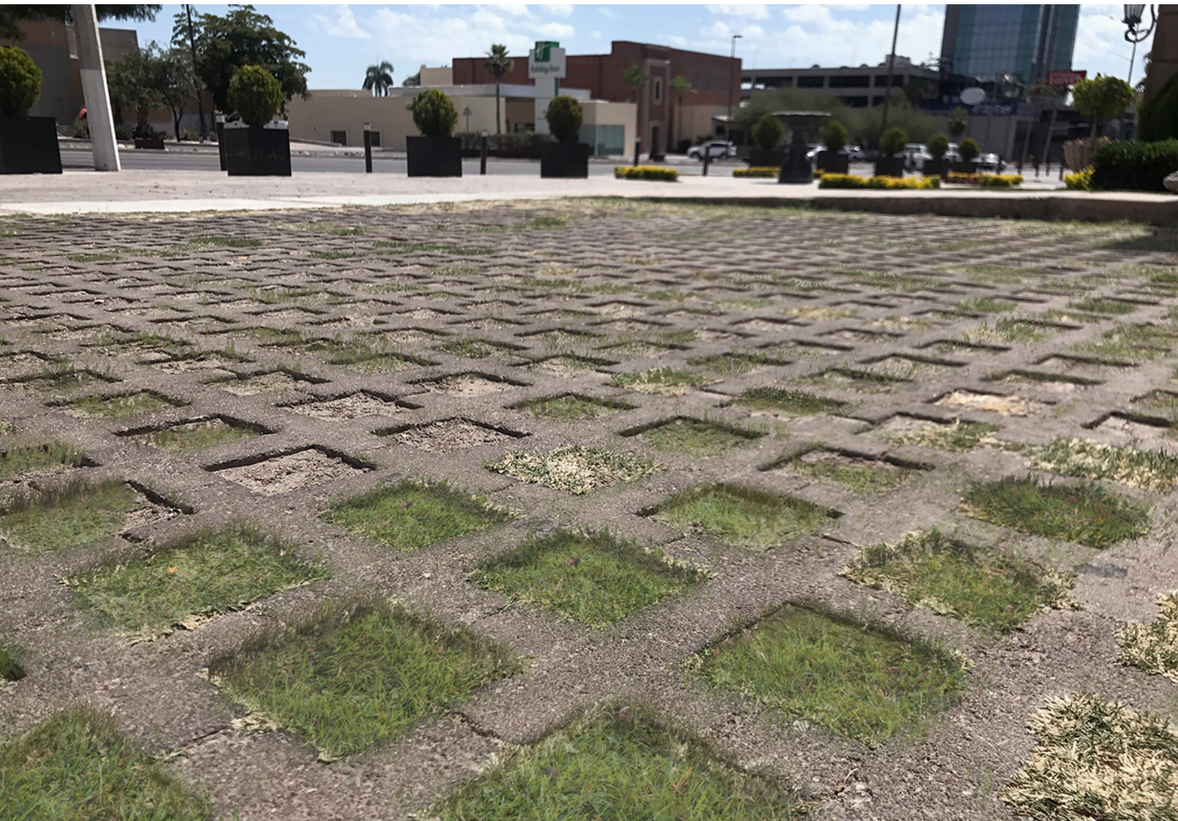
Fotografía Eduardo Hinojosa Robles Bulevar Eusebio Kino y Calle José Lafontaine, Hermosillo, México 1 de junio, 2017 Ado-pasto instalado en estacionamiento de edificio comercial.
