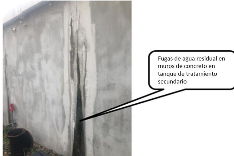
Figura 3 Fugas en Muros de Concreto del Tanque de Tratamiento Secundario
