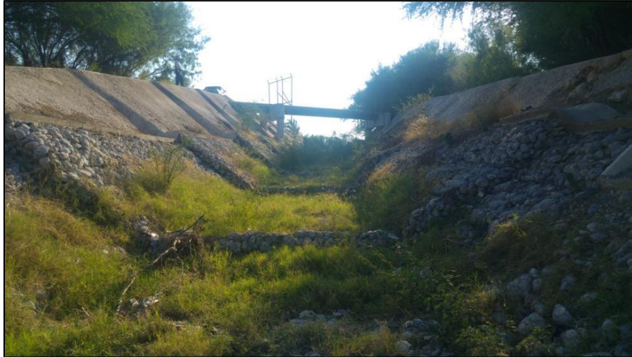
Figure 3 LA MISIÓN STORM WATER CHANNEL
